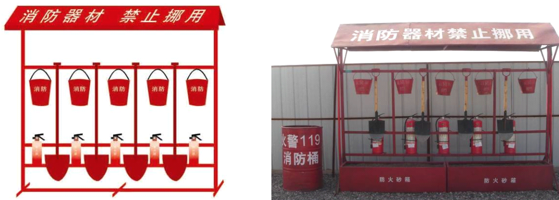
图 64 消防器材及相关设施示例
